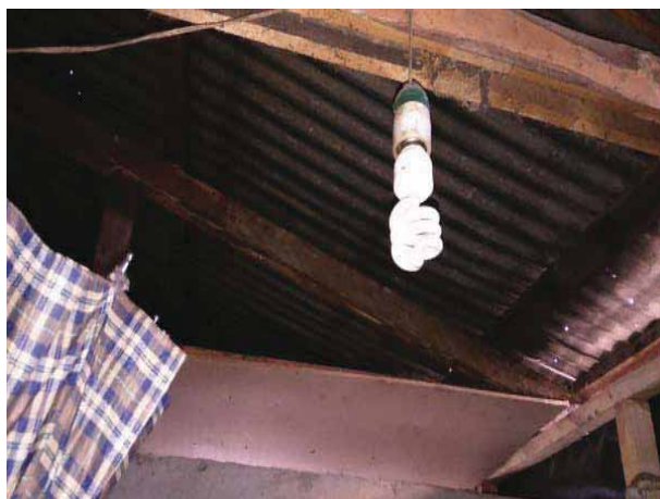
Vivienda sin solución habitacional
